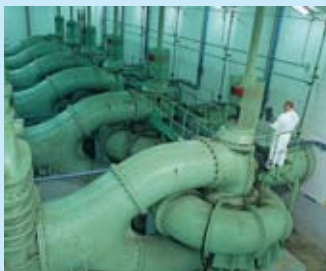
Pompe dell'impianto di Sabbiuncello. Foto archivio Consorzio Bonifica Burana
